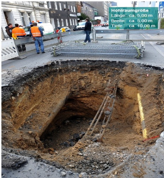
Bild 56: Freigelegter Hohlraum in der Gasstraße [Foto: Technische Betriebe Solingen]
