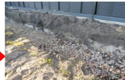
USO DE BRITA (CAPA DRENANTE) E AREIA (MATERIAL DE BASE E NIVELAMENTO)
